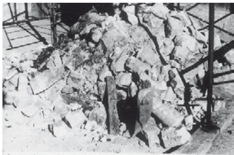
Fig. 19. Catedral de Burgos. Aspecto del campo de trabajo durante una intervención de sustitución de elementos ornamentales deteriorados en 1980. Cuando la intervención se propone sustituir los elementos degradados por otros nuevos una de las consecuencias es la destrucción de los restos del original que, como escombros, se hará desaparecer en el vertedero, o como recuerdos irá a decorar algunos jardines privados o públicos. La conservación del original es algo a lo que la ley actualmente vigente obliga y quienes actúan de forma contraria deben ser señalados cuando, como en este caso, existe la denuncia formal presentada por el director del ICROA, aunque la realidad nos muestra que las sustituciones continúan y que lo opuesto a lo que dictamina la ley se da como norma de trabajo en discurso leído ante la academia.
