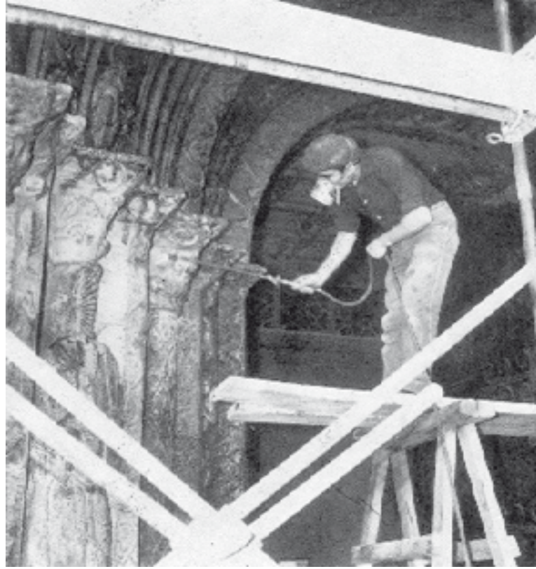
Fig. 22. Detalle de los trabajos de consolidación de la portada. Noviembre de 1964. Negativo: Archivos del I.C.C.R. Madrid. Excelente homogeneidad y suavidad en la aplicación del producto consolidante se obtuvo con un pulverizador de baja presión (de los empleados en agricultura para sulfatar los árboles). El empleo de caretas antigás era imprescindible, dada la toxicidad crónica del disolvente empleado.
