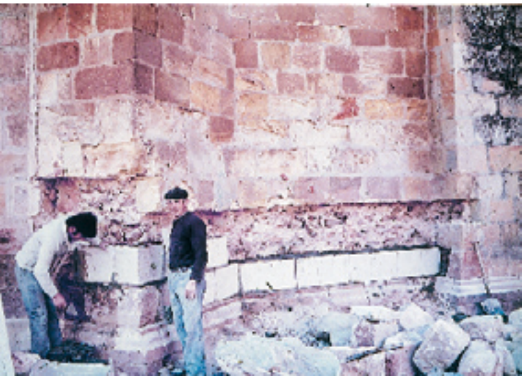
Fig 5. Trabajos de sustitución de sillares afectados por la ascensión capilar de agua en la concatedral de San Pedro de Soria. Este tipo de reparaciones se ven frecuentemente y tienden a mejorar el aspecto externo de las zonas erosionadas. Desgraciadamente, al no poner solución al movimiento unidireccional del agua absorbida por la masa del relleno del muro, ocasionan una ascensión mayor en las zonas interiores y exteriores próximas, por la menor permeabilidad de la roca nueva que reduce el grado de evaporación.
