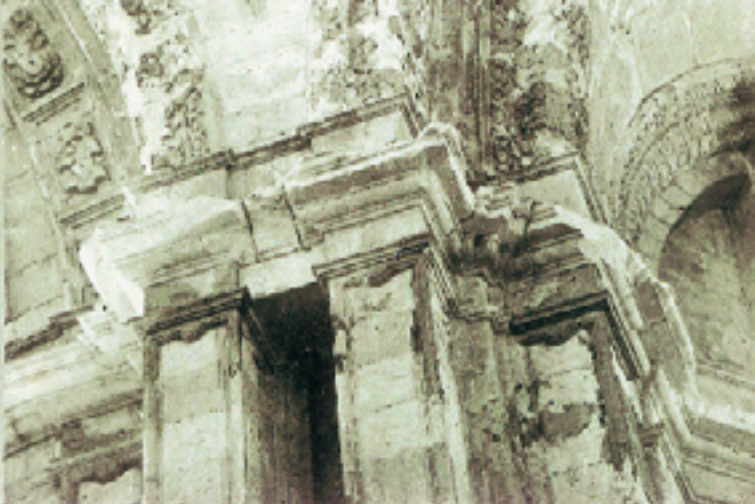
Fig. 11 y 12. Catedral de Cádiz. Detalles del interior mostrando la rotura de fragmentos de piedra. La caliza de Estepa contiene sulfatos solubles en agua que cristalizan en el interior de los poros de la roca con presiones suficientemente altas como para justificar las roturas. Los ciclos de eflorescencia y cristalización de estas sales, dependiendo de la humedad relativa del aire, determinan el proceso.
