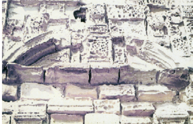
Fig. 10. Iglesia del Salvador. Gijón. Fenómeno de "corrosión" en la arenisca de Somió por la acción de los cloruros del agua del mar
