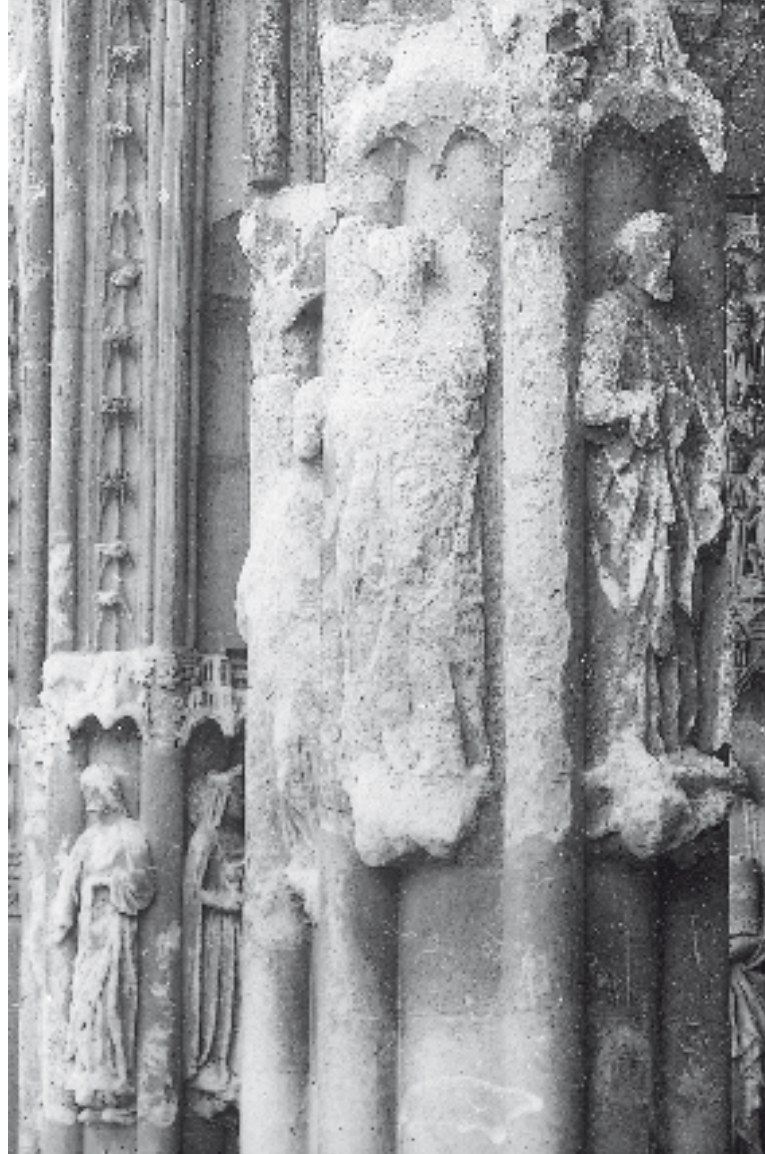
Aspecto de las esculuras bajo las gárgolas, afectadas por el agua.
