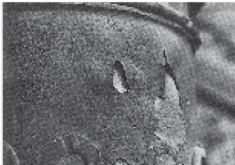
Fig. 2. Catedral de Palma de Mallorca. La aplicación de alumbre férrico a la superficie de la piedra origina la formación de ampollas, fenómeno este muy generalizado en la fachada principal. Aunque este alumbre tiñe muy bien las calizas blancas, es sabido que "quema" la superficie y genera el tipo de alteración que muestra la imagen. Actualmente, técnicos mal informados están aplicando el alumbre directamente en alguna fachada monumental, lo que ocasionará daños. La aplicación correcta del alumbre, según nuestra información, lo considera como un ingrediente de una formulación más compleja en la que desempeña el papel de protector de la cola animal.
