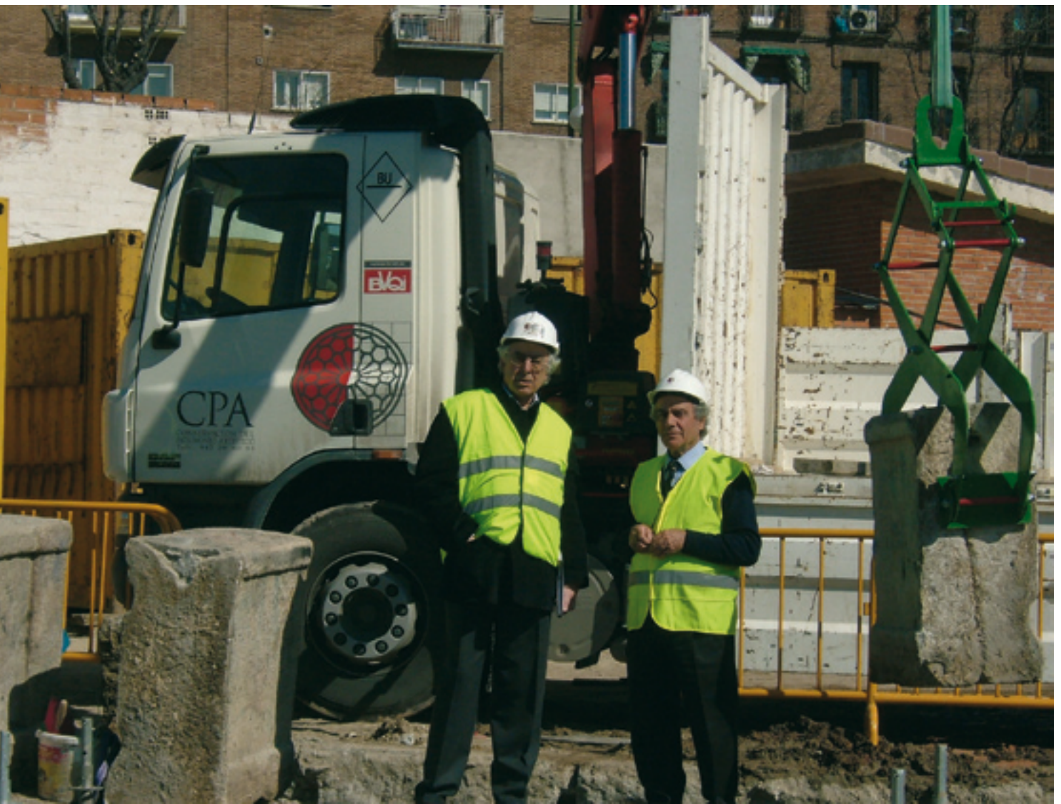
Con José Miguel Avila durante el desmontaje de la cantería de granito en un tramo del decendedoro sur.
