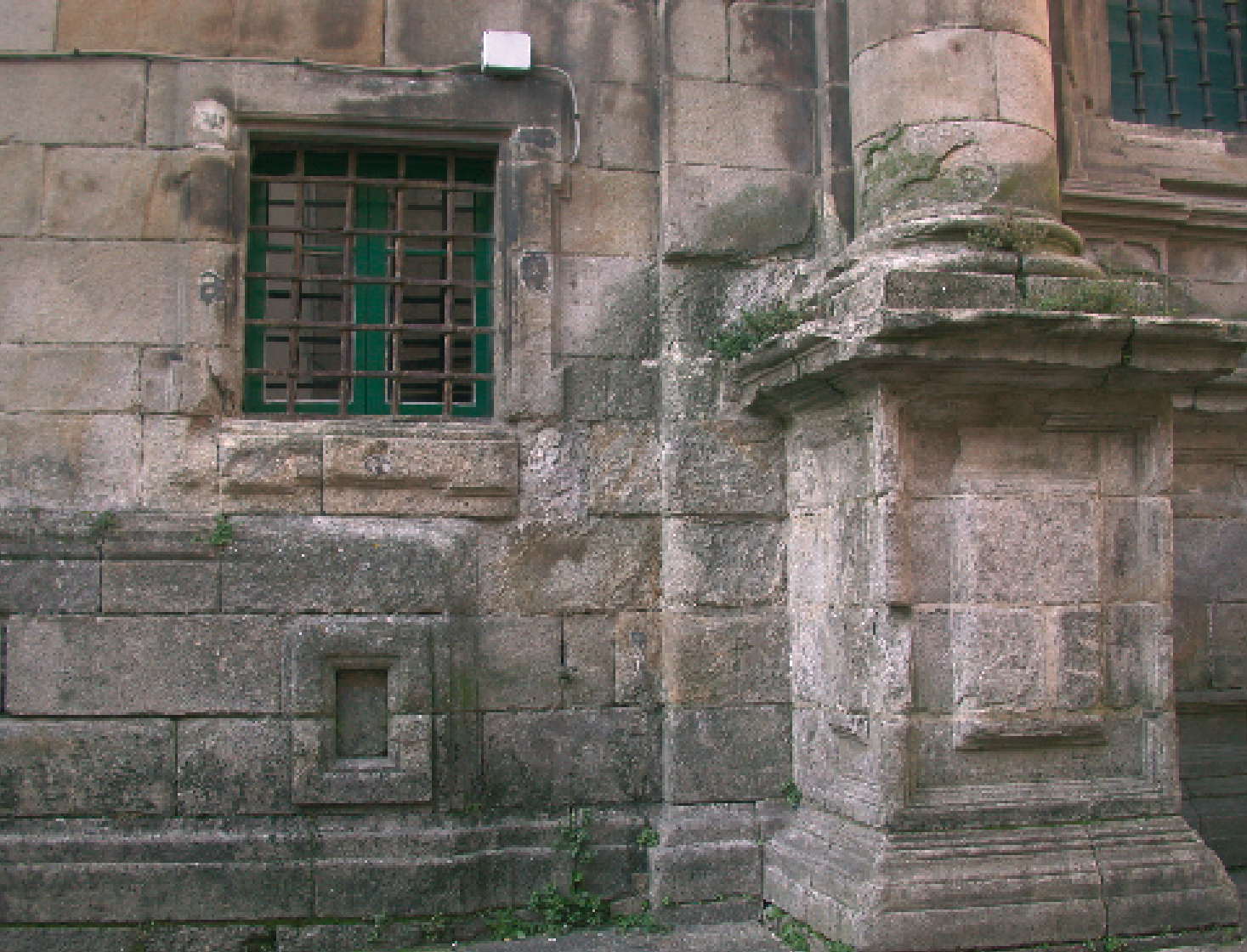
Deterioro inicial del basamento petreo de San Pelayo.
