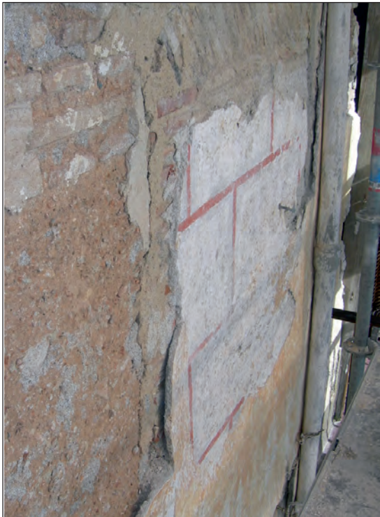
Fig. 1. Pintura mural sobre revoco de cal, imitando sillería almohadillada. Estado antes de su conservación/restauración.
