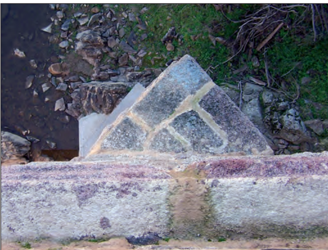
Fig. 3. Detalle en la pila 4 del zuncho de hormigón.
