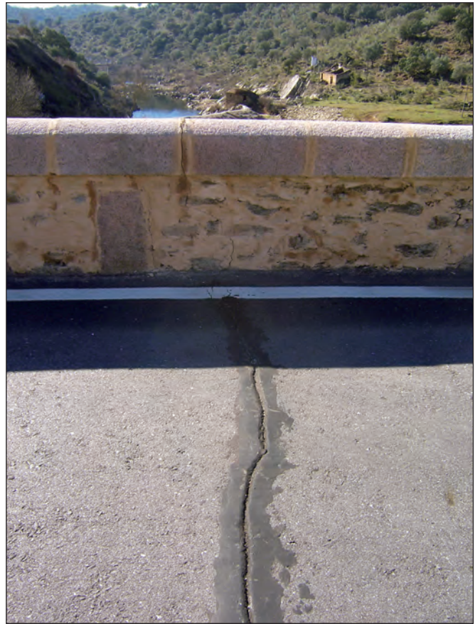
Fig. 2. Grieta atravesando el aglomerado y el pretel.
