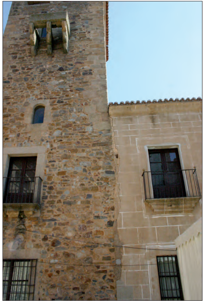
Fig. 2. Palacio de los Golfines de Abajo (Cáceres). Testigo de la eliminación del revestimiento en la torre.
